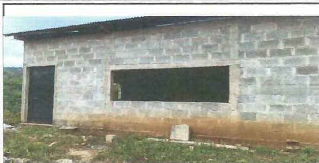
Foto: 1 REPELLO DE COCINA EXTERIOR. las paredes sin repello pueden acumular fácilmente suciedad, grasa, humedad y ser un caldo de cultivo para bacterias, moho y plagas.
