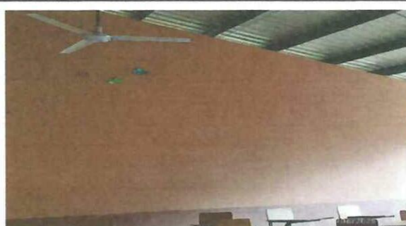
Foto: 4 La pintura desgastada, sucia o descascarada puede generar un ambiente lúgubre y desinteresado, afectando negativamente la experiencia de aprendizaje.
